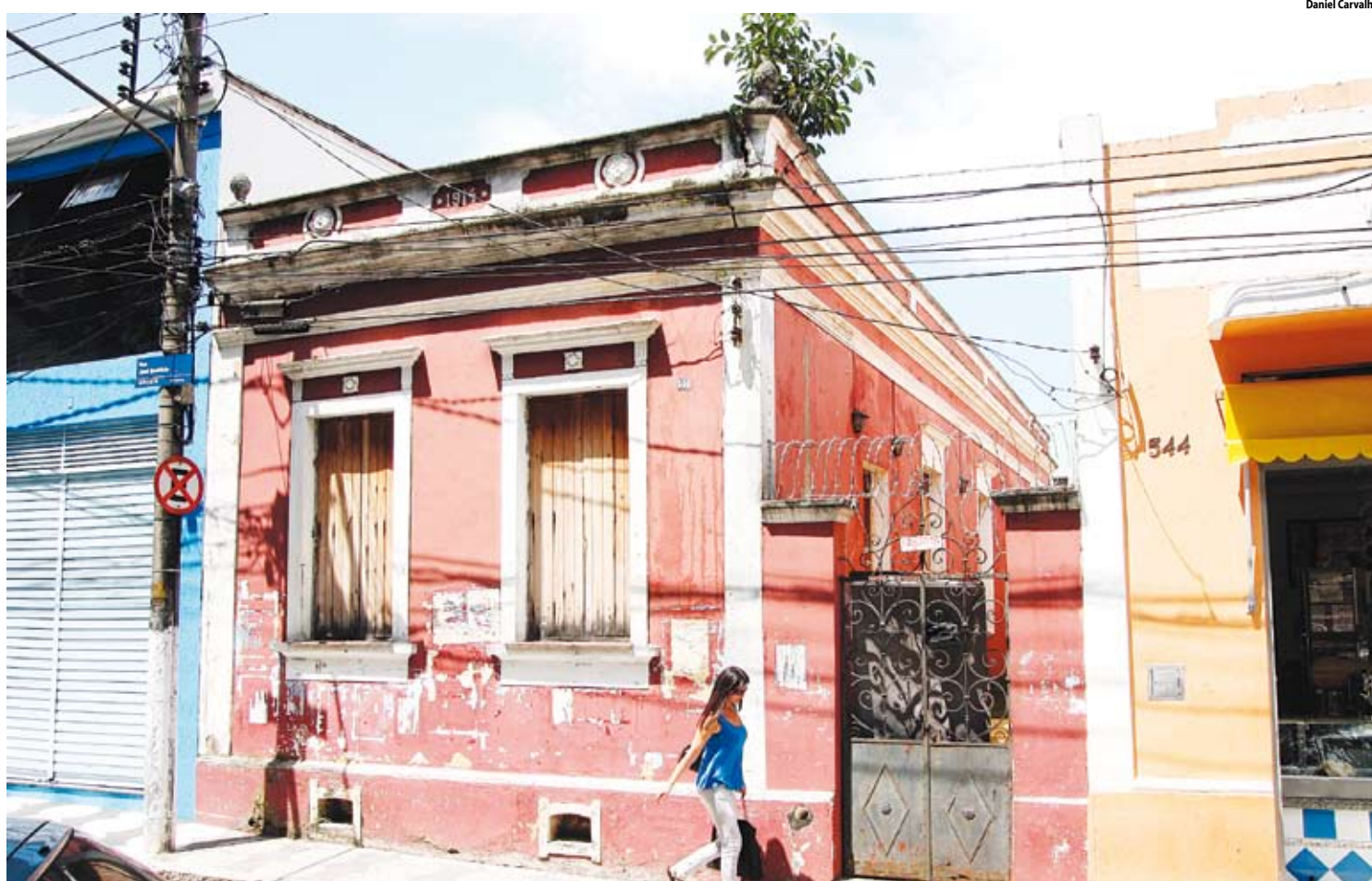
» Risco | Rachaduras em parte da estrutura de um casarão tombado como patrimônio da cidade na rua José Bonifácio, 555, na região central de Mogi, têm preocupado a população. Comerciantes e pedestres temem que a estrutura caia sobre alguém. CIDADE, PÁGINA 7
